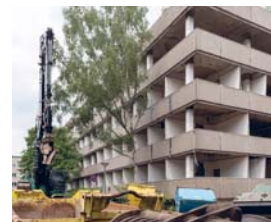
Der Geschossbau IV wird momentan abgerissen, der Abriss von Geschossbau V folgt.
