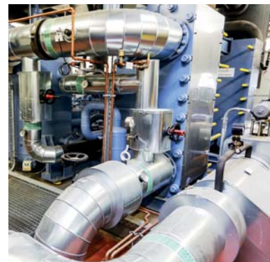
Mit Hilfe von Absorptionskältemaschinen wird Kälteenergie produziert. Foto: Oliver Schaper
