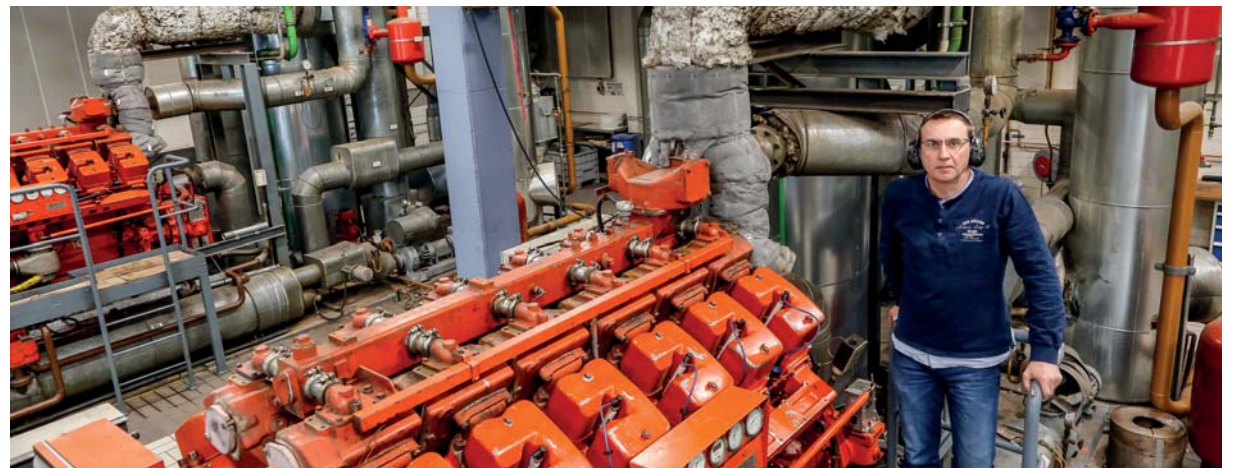
Die orangenen Motoren sind das Herzstück des Blockheizkraftwerks, für das Fredy Schad und seine Kollegen zuständig sind. Foto: Oliver Schaper
