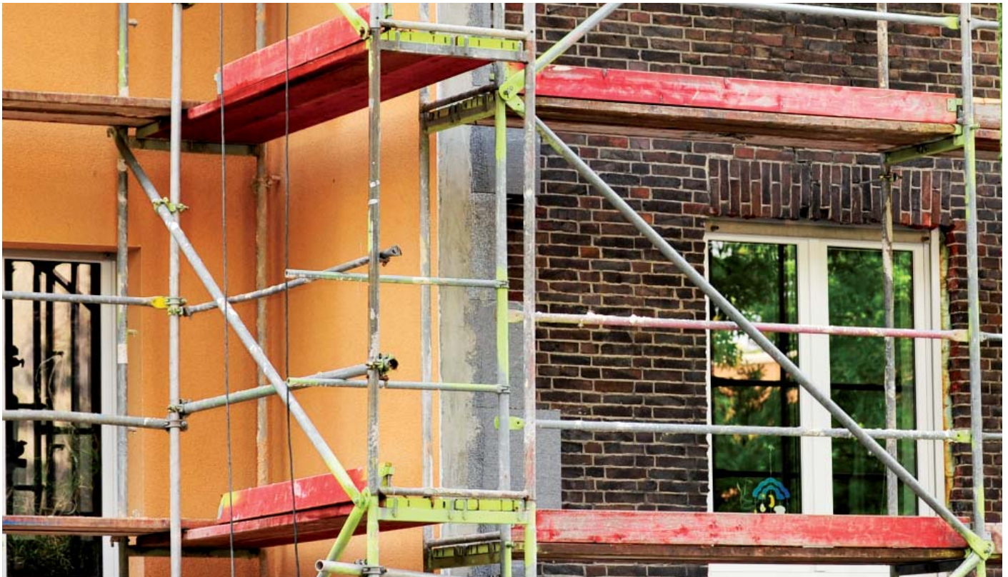
Ein Altbau vor – und nach der Fassadensanierung: Durch die Dämmung (links) wird auch die Optik der alten Fassade komplett zerstört.
