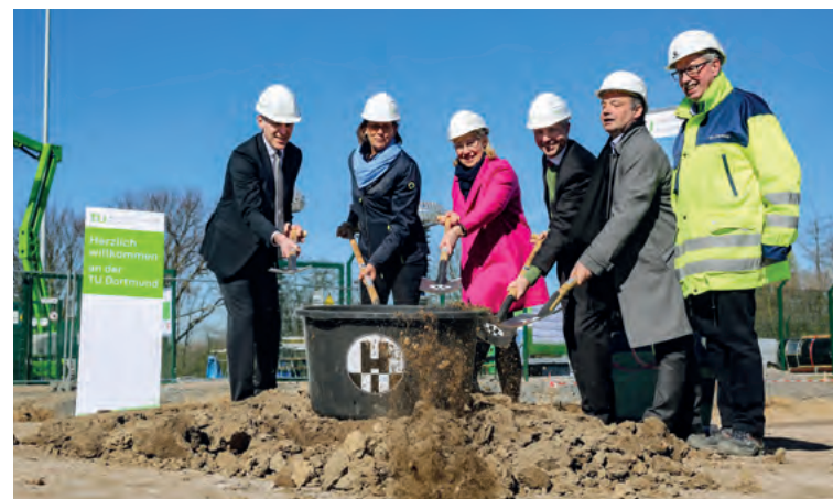
Grundsteinlegung im Frühjahr 2017: Die Halle des Testzentrums ist 35 Meter lang, 25 Meter breit und 23 Meter hoch.
