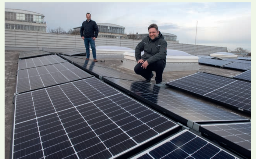
Die 136 Photovoltaik-Module auf dem Dach der Versuchshalle des ISF werden von Peter-Paul Kilian (r.) und Christian Suerkemper vom Dezernat Bau- und Facilitymanagement begutachtet. Foto: Martina Hengesbach
