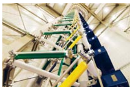
Der Impulsgenerator im HGÜ ist 15 Meter hoch, rund 16 Tonnen schwer und besteht aus 20 baugleichen Teilen. Foto: M. Hengesbach
