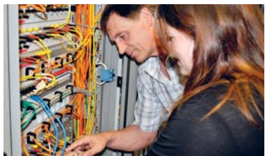
Zwischen Kabeln und Schaltern hilft Ausbilder Klaus Philipp den Berufsanfängern dabei, den Durchblick zu behalten. Foto: D. Schmidt
