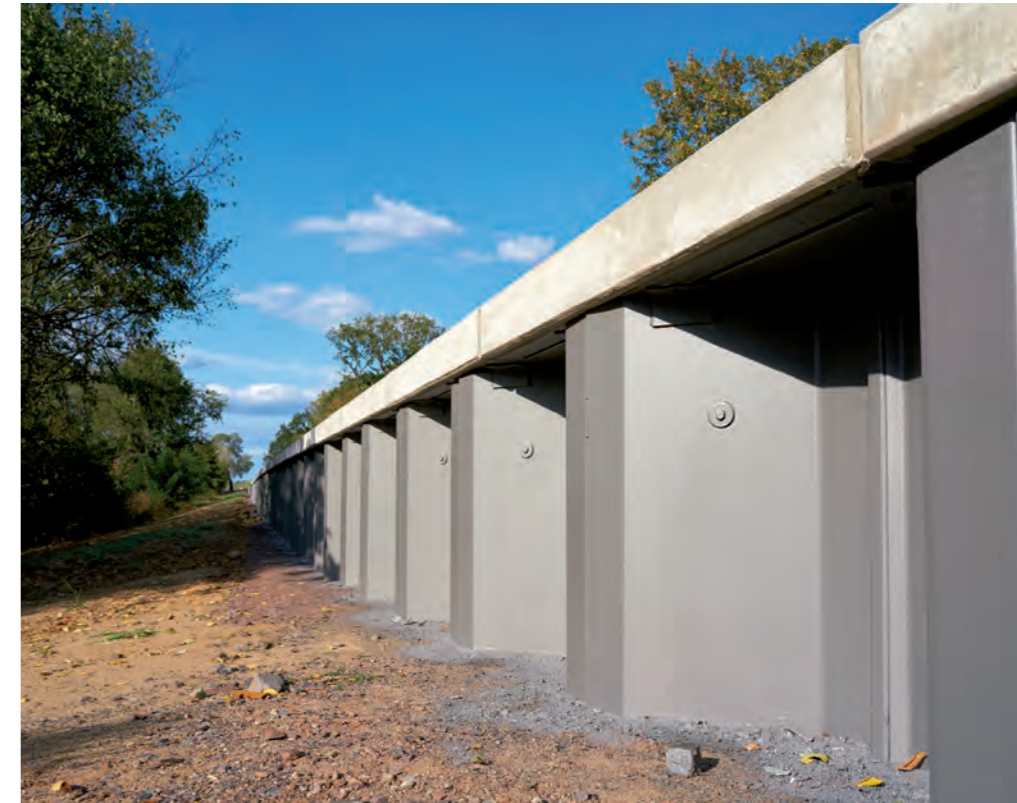
Hochwasserschutzmauer am Elbufer bei Magdeburg: Bauwerke wie diese sollen vor der nächsten Jahrhundertflut schützen.
